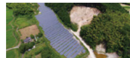
物件名 所在地 日立嘉麻太陽光発電所 福岡県嘉麻市
