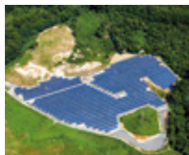
S-03 CS笠間市発電所
