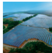
S-13 CS益城町発電所
