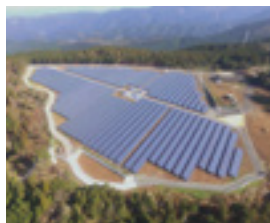
S-09 CS芦北町発電所
